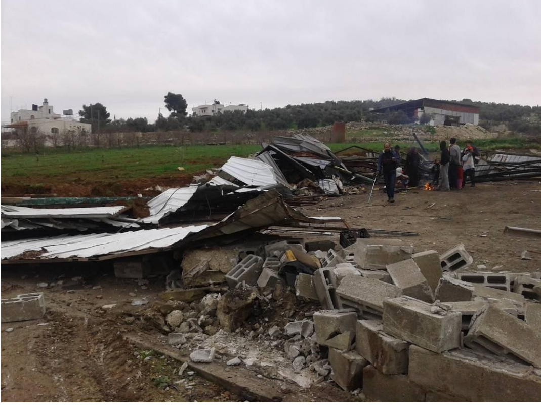
منشأة أبو جحيشة المهدومة - بلدة إذنا
